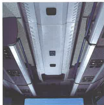
Aria condizionata a diffusione individuale
